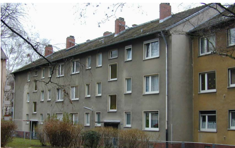
Bild 39: Alte Kamine, die vor der Montage einer PV-Anlage möglichst entfernt werden sollten
